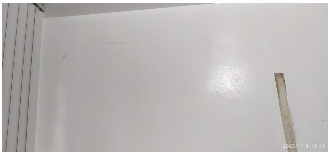
Foto 05: Consultório 2 com pintura com fissura e parede danificada.
