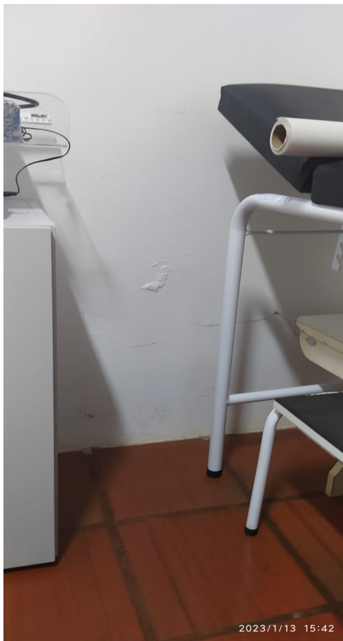
Foto 08: Bolhas existentes na pintura por possível infiltração.
