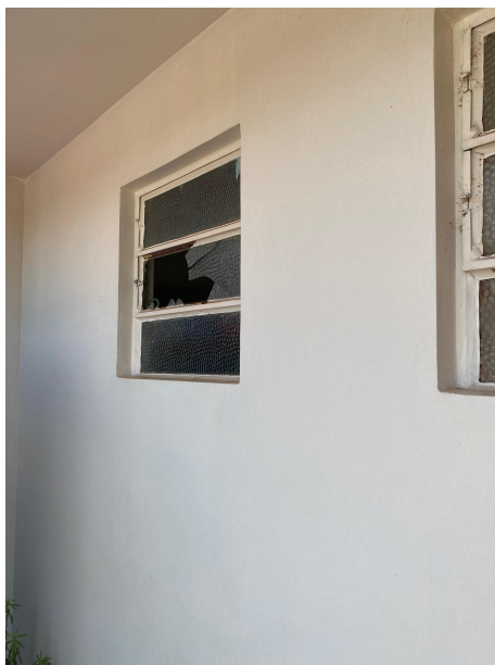
Foto 10: Hall de acesso ao banheiro com vidro danificado na janela da Sala de Apoio.
