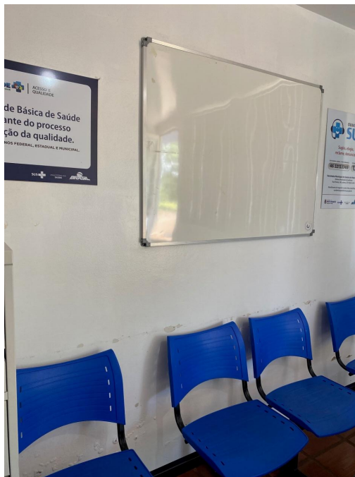
Foto 12: Atendimento da Unidade de Saúde com danificações na pintura.
