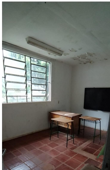
Foto 10: Sala de aula com infiltrações no teto e danificações em geral.
