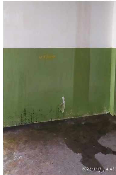
Foto 11: Problemas registrados com calha existente.
