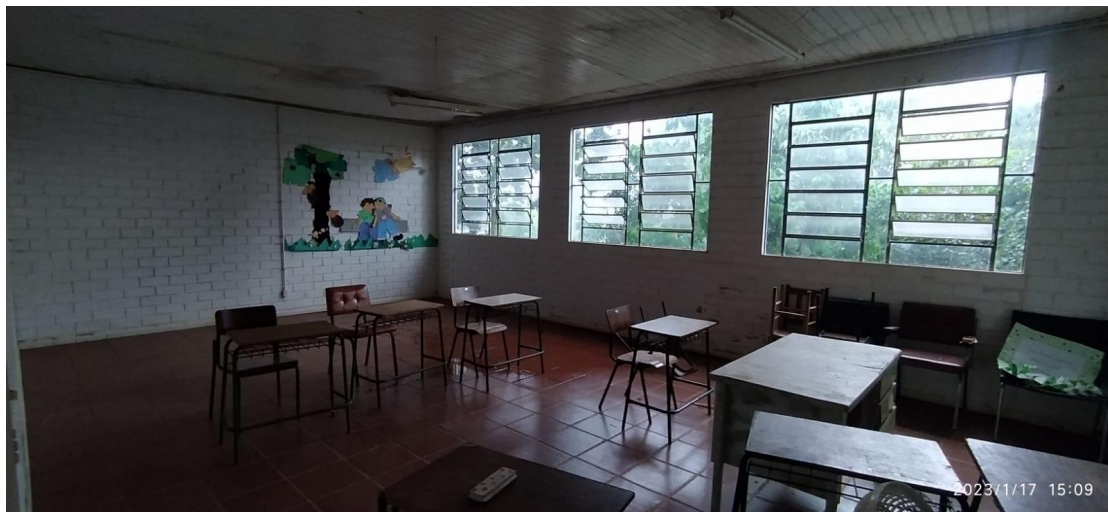
Foto 8: Salas de aula com goteiras.
