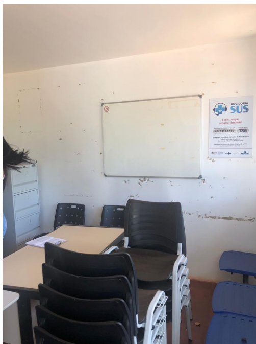
Foto 07: Sala de atendimento com danificações na pintura.
