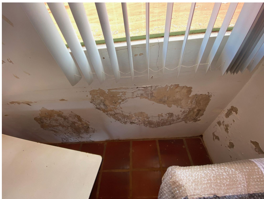
Foto 10: Danificação por infiltração antiga.
