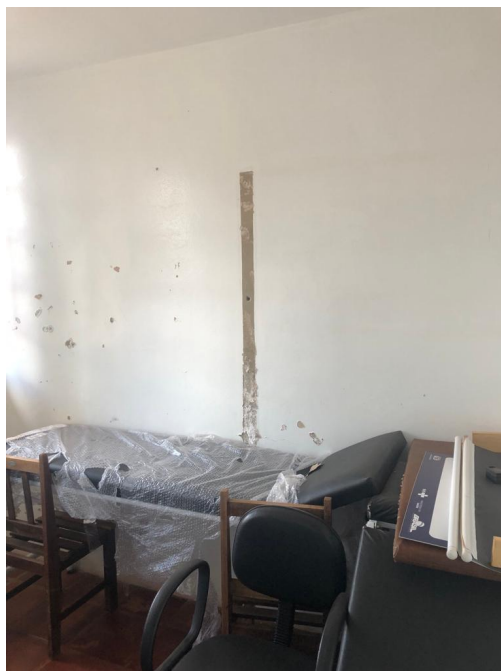
Foto 09: Consultório 1 com danificações na pintura.
