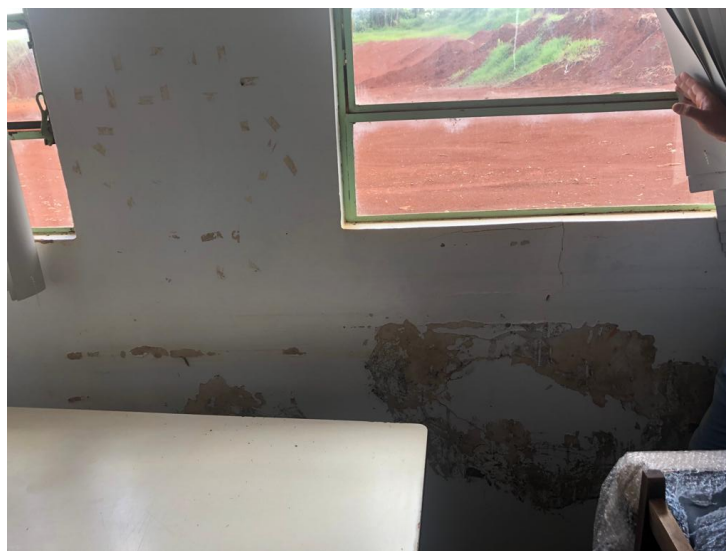
Foto 09: Consultório 1 com danificações na pintura causadas por infiltrações antigas.
