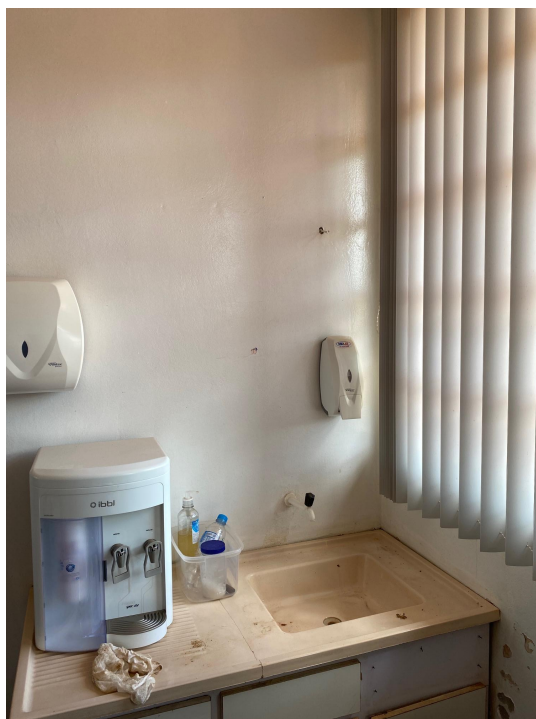
Foto 11: Danificação de pintura no consultório 2.
