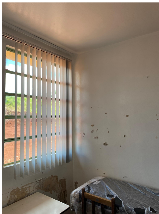
Foto 08: Consultório 1 com danificações na pintura.
