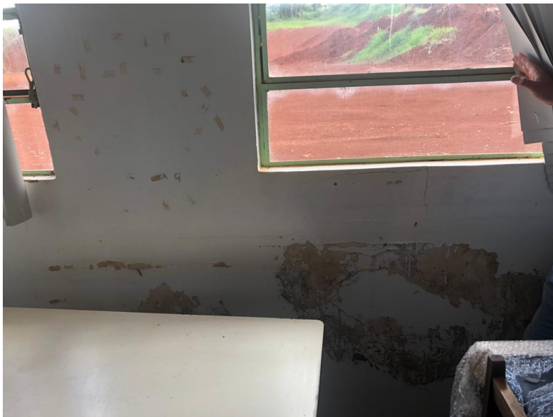
Foto 12: Danificação de pintura por infiltração antiga no consultório 2.
