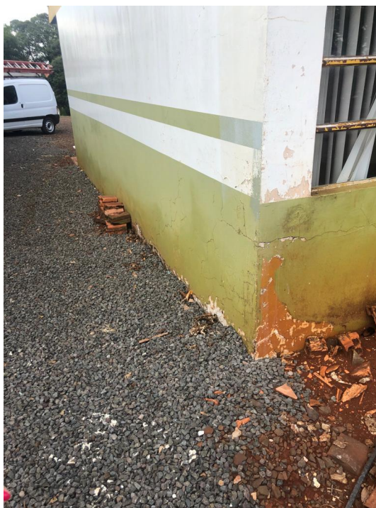
Foto 06: Identificação de problemas na pintura da fachada dos fundos.
