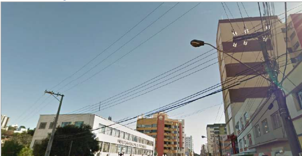
Figura 131 - Rede elétrica aérea na Rua Caramuru – ADA
